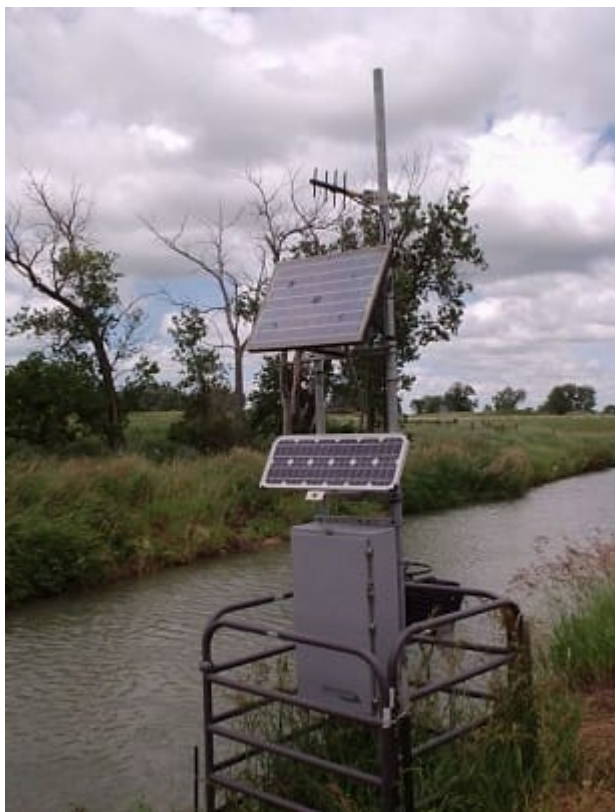
Рис. 1. Элементы технологической радиосети автоматизированной системы управления оросительными каналами: радиомачта с антенной, блок-бокс с электронным оборудованием и аккумуляторами, солнечные батареи. (Фото: www.rubiconwater.com , www.campbellsci.com/south-dakota-irrigation )
