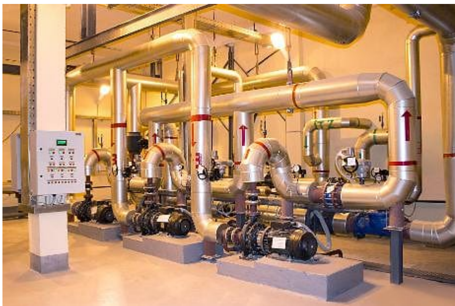
Объекты, оснащаемые АСУ ТП ЖКХ
