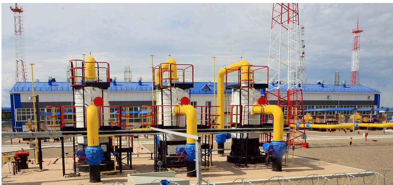
Рис. 2. Компрессорная станция «Парабель» Томское линейно-производственное управление магистральных газопроводов (фото ООО «Газпром трансгаз Томск»).
