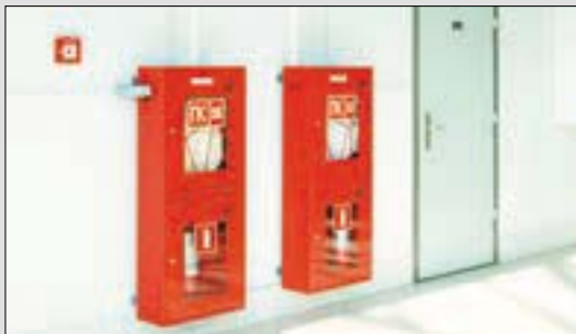
Пожарный кран внутри помещения
